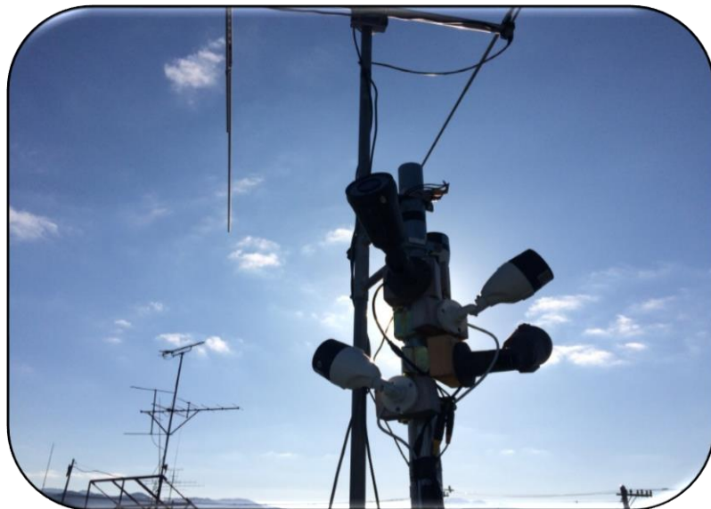
全方位をカバーする屋上に設置された IR カメラ 4 台
